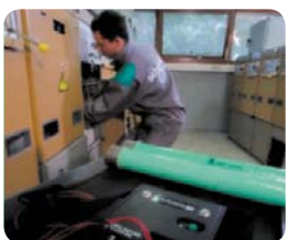
ProFusion, Diagnóstico del funcionamiento de fusibles de MT
