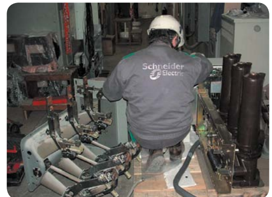
ECOFIT de un interruptor en MT.
