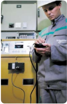
Pruebas de equipos
