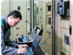
ProSelect, Diagnóstico de la unidad de disparo de un interruptor en aire en BT.
